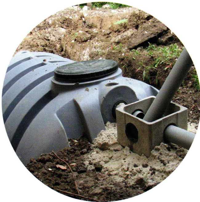
Installation d'une cuve enterrée. En raison du coût lié au terrassement, il est préférable de prévoir cet équipement lors de la construction, dans le cas d'une maison neuve.
